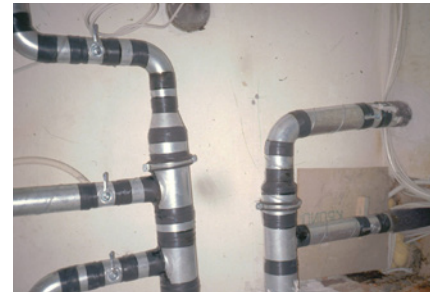
Von unten gegen die Decke fotografiert: Teile eines Kanalnetzes aus Wickelfalzrohr. Alle Verbindungen sind zum Schutz gegen Leckagen mit elastischem Klebeband verschlossen.
